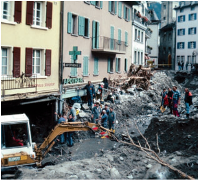
Brig nach dem Unwetter: In den Strassen türmen sich Geröll, Schlamm und Schwemmholz.
